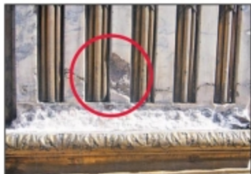
ROTURAS. Pedazos fueron sacados con una zapa.
